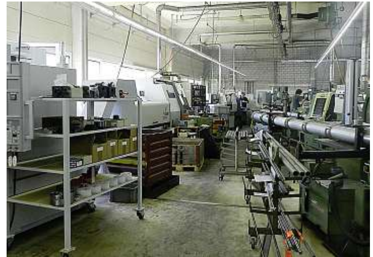
Der Maschinenraum der Kurt Schneider AG.
